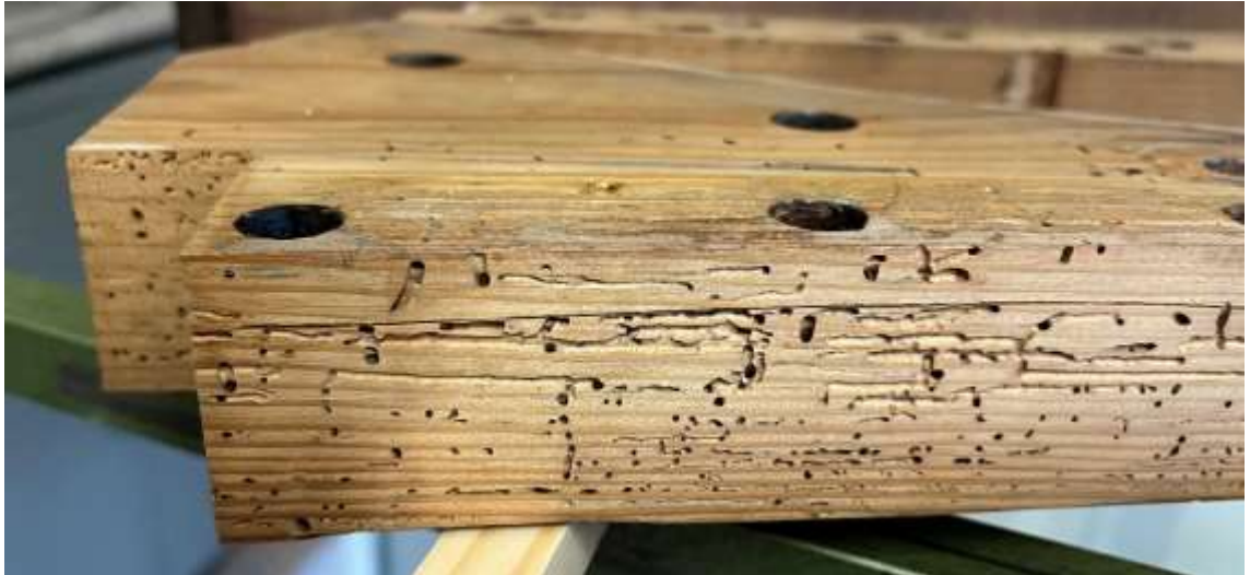
Abbildung 37 Wurmlöcher und Risse in den Stöcken v.d.R.
