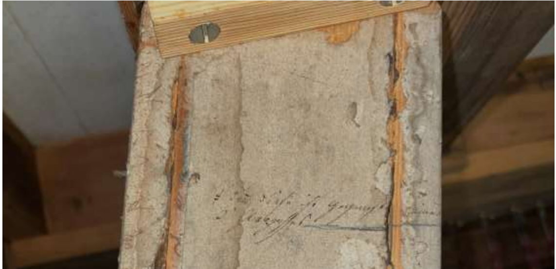
Abbildung 57 Risse im Kanalsystem v.d.R.
